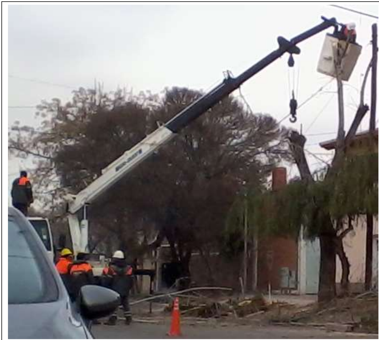
Fig Uso inadecuado de brazo hidráulico
