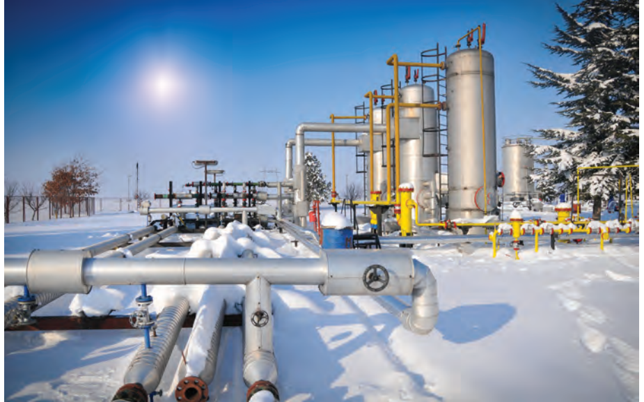
Figura 16. Planta de tratamiento de gas.
