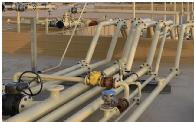
Sistemas de Tuberías
