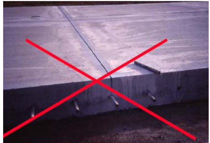
Ubicación inadecuada cerca de la junta transversal
