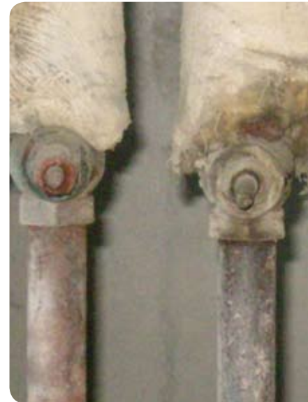
Aislación: Asbesto / Amianto.
