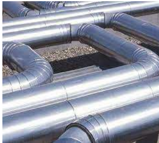
Figura 20: Revestimiento térmico de cañerías
