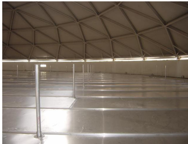
Figura 16 Vista interior de techo flotante interno
