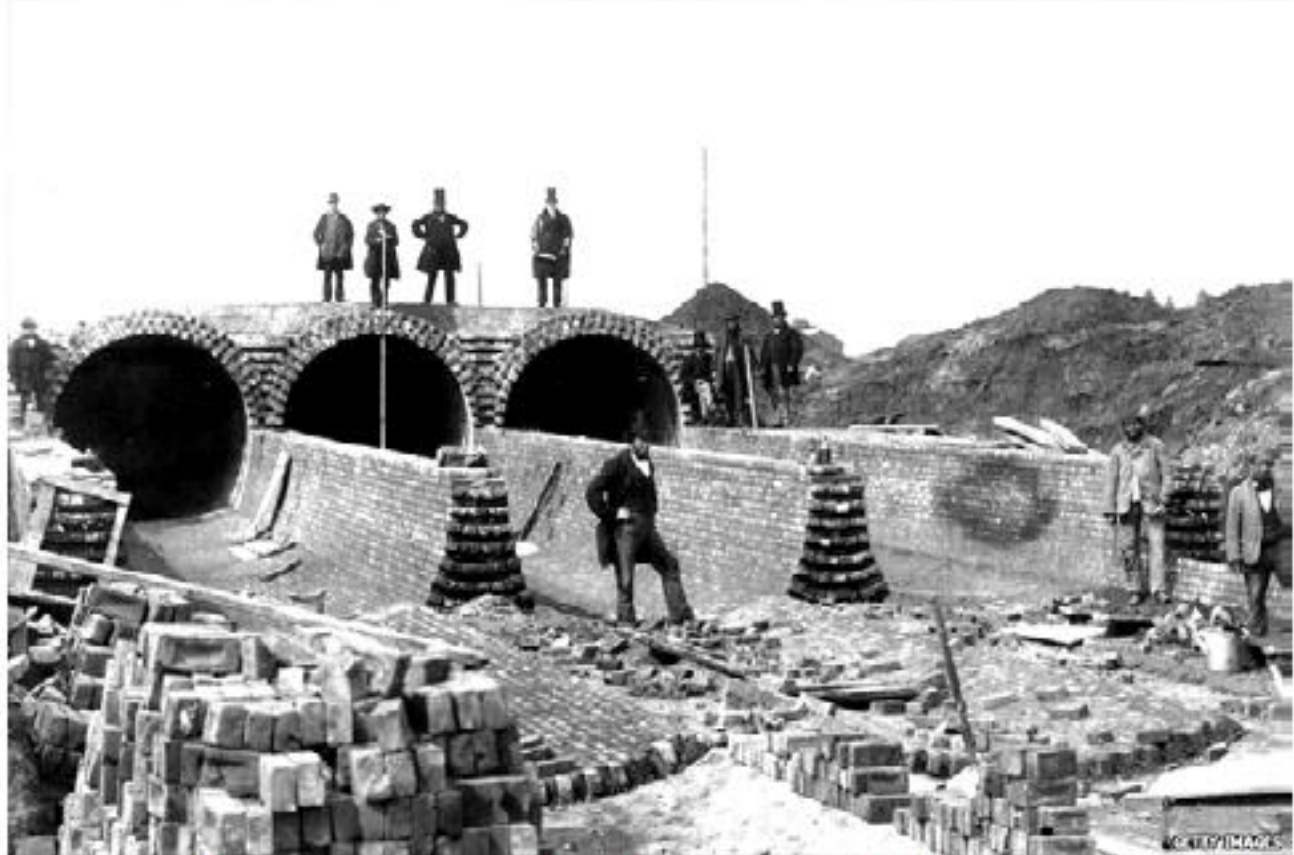
Construcción de la red de alcantarillado de Londres, por Sir Joseph Bazalquette, hacia 1860.
