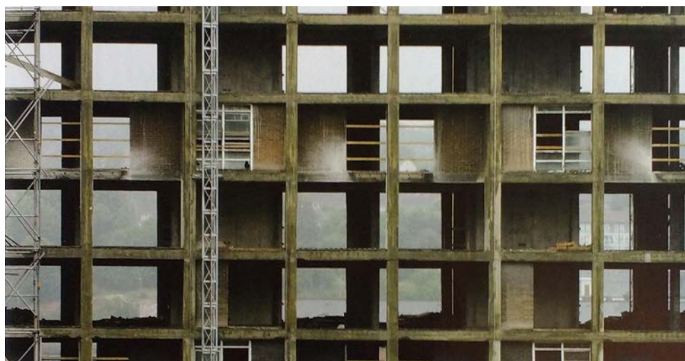
Fig. 17 Estructura del edificio completamente vacía durante las obras de restauración. Imagen de Keith Collie (Blueprint, 2010).
