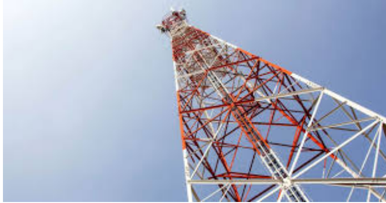
Figura 3: Antena de telefonía
