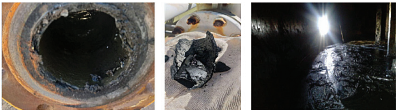
Figura 14. Muestras de ensuciamiento encontrado en las instalaciones de planta.
