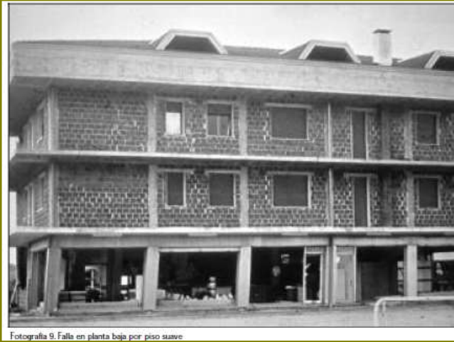
Fotografía 9. Falla en planta baja por piso suave
