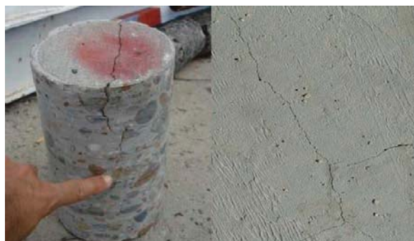
Figura 5 - Fisuras por contracción térmica en pavimentos y pisos industriales
