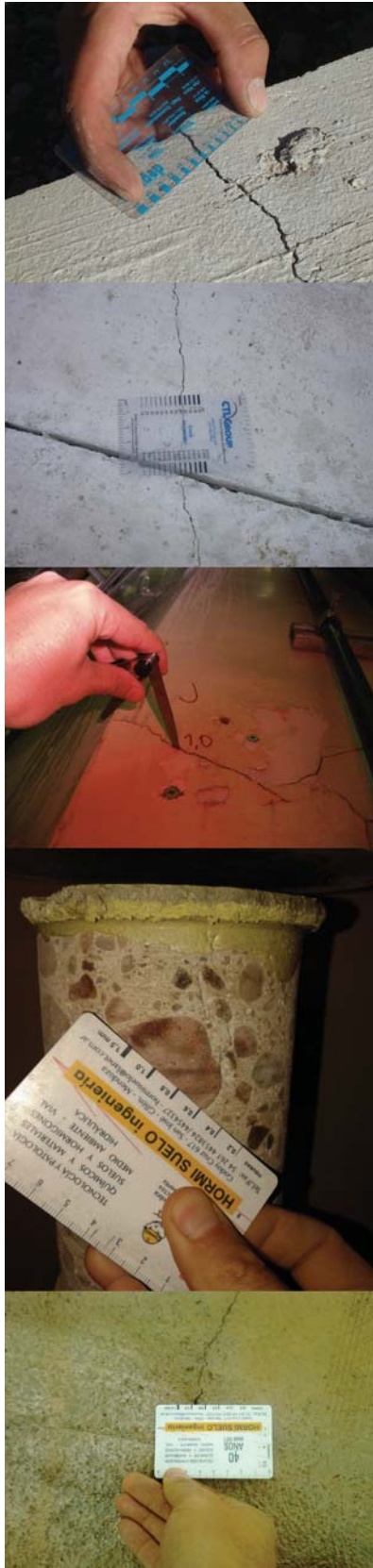
➤ Figura 2. Medición de ancho de fisuras para relevamiento general
