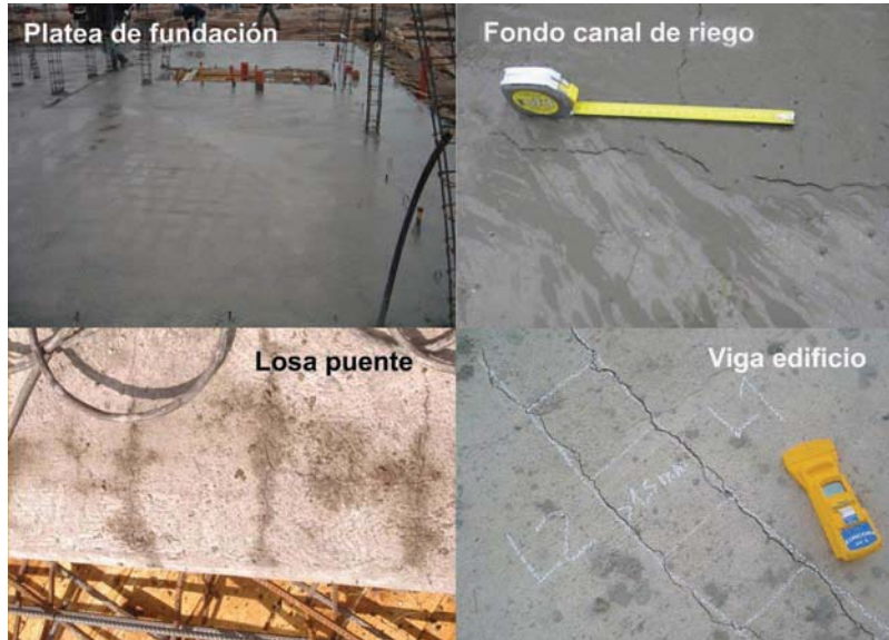
Estructuras varias con fisuras por asentamiento plástico.
