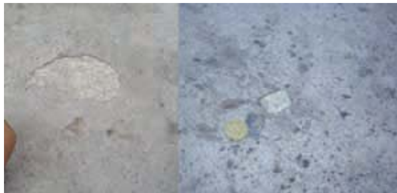
2. Delaminaciones en pavimentos no llaneados
