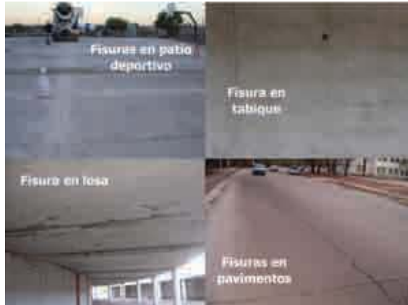
FIGURA 2.1 - Fisuras por contracción por secado
