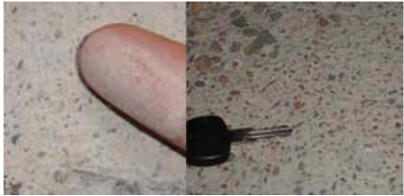
3. Empolvamiento superficial en pisos
