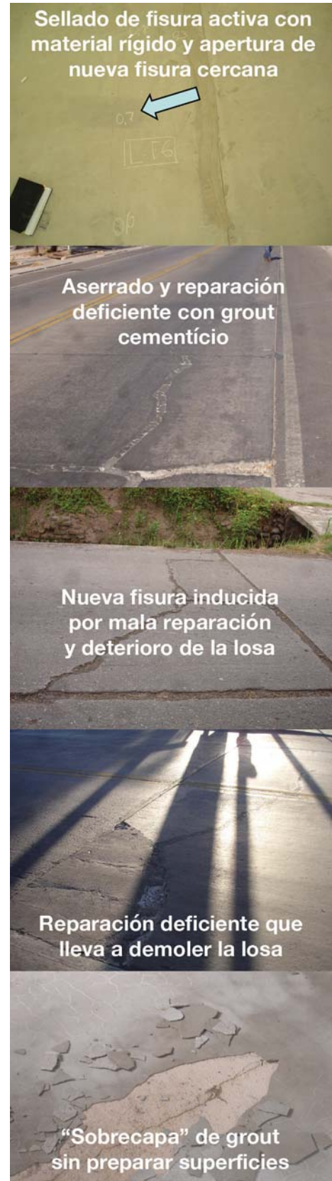
Figura 1. Daños adicionales provocados por reparaciones no eficientes
