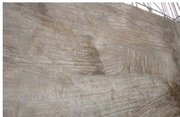
Figura 3 - Mala aplicación del desmoldante
