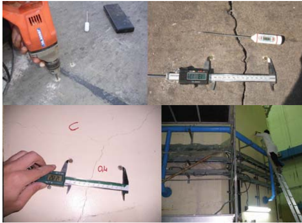
Figura 6. Testigos insertos para seguimiento con precisión de fisuras
