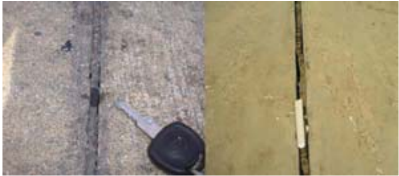
4. Sellado de juntas despegado en losas alabeadas de pavimentos (izquierda) y piso industrial (derecha)
