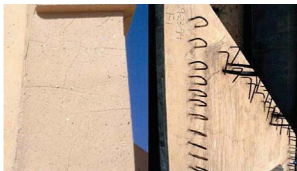
Figura 4 - Fisuras por contracción térmica en estructuras masivas
