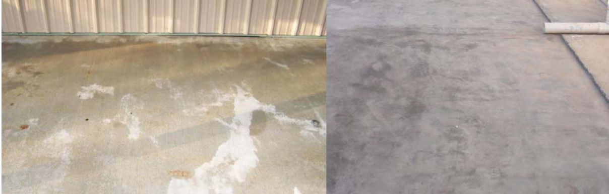
▲ Figura 1 - Decoloraciones provocadas por inadecuadas técnicas de puesta en obra
