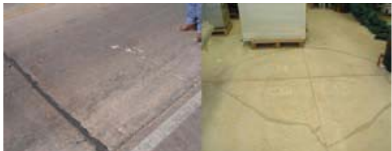
2. Fisuras de esquina típicas de alabeo en pavimento (izquierda) y piso industrial (derecha)
