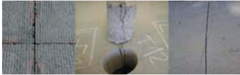
3 Astillamientos en zonas de juntas
