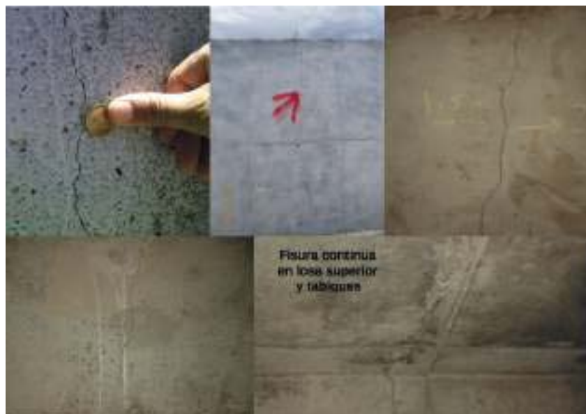
F4 Ejemplo de fisuras relevadas en alcantarilla de hormigón simple y distribución de juntas propuestas
