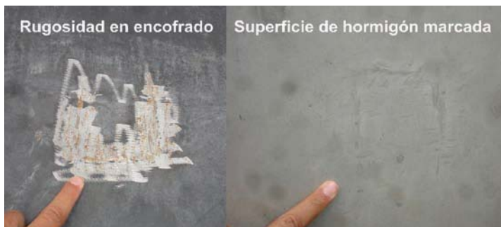
Figura 5 - Copia de defectos del encofrado en la superficie del hormigón
