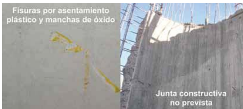
Fisuras por asentamiento plástico y juntas no previstas
