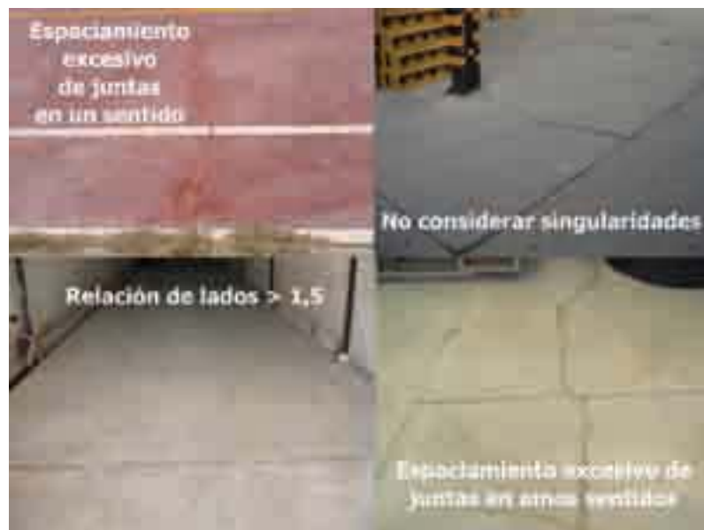
FIGURA 2.2 - Inadecuado diseño de juntas
