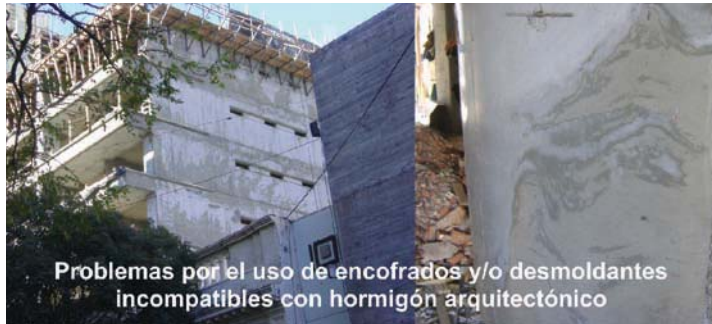
Figura 1 - Encofrados incompatibles con hormigón visto
