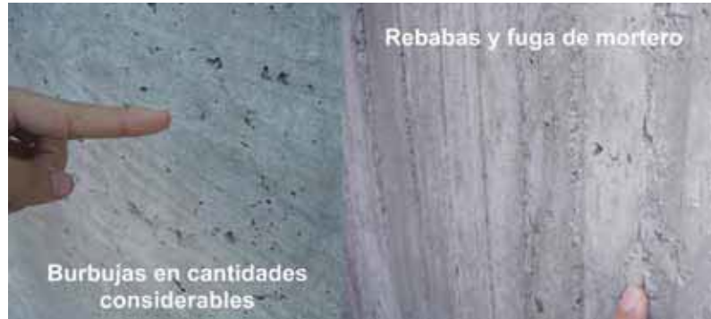
Formación de burbujas y rebabas con fuga de mortero
