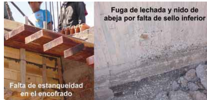
Falta de estanqueidad y fuga de lechada
