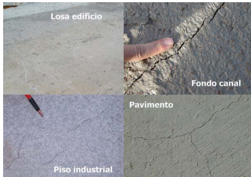
Figura 1 - Fotografías fisuras contracción plástica
