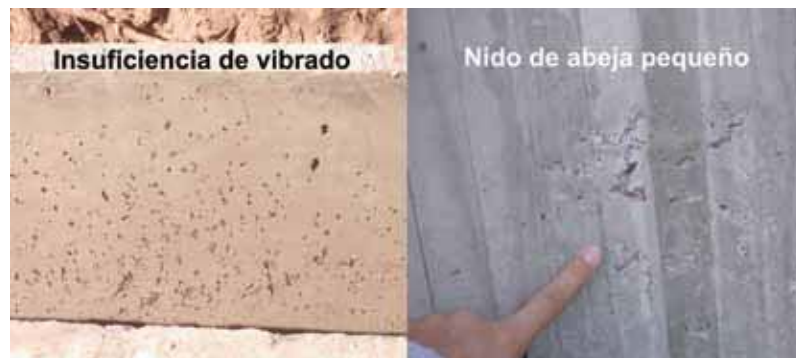
Defectos de compactación y nidos de abeja
