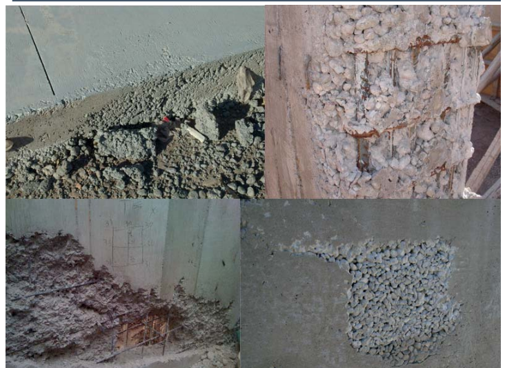
Fig. Defectos en caras encofradas (nidos de abeja)
