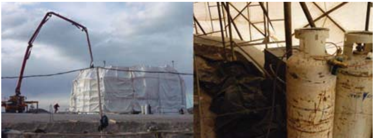
► F2: Protección activa con recintos cerrados (Antena Aeroespacial Malargüe - Mendoza)
