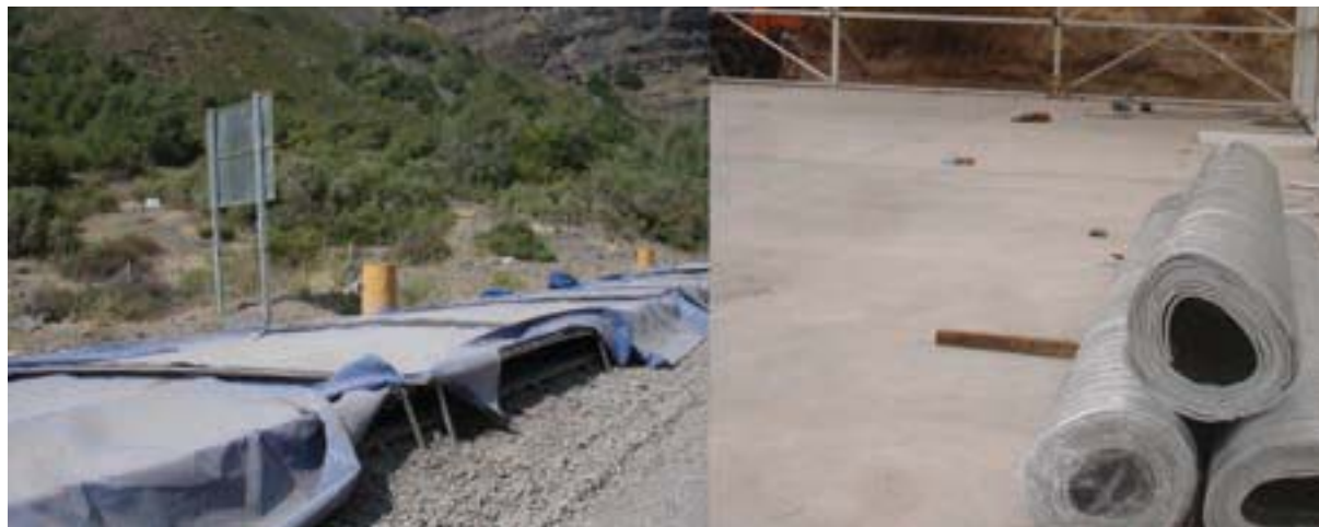
▲ F4: Protección pasiva con aislantes térmicos
