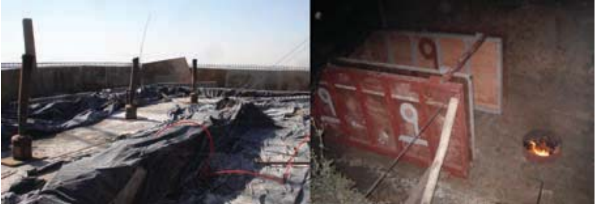
▲ F3: Protección activa en ambientes al aire libre (losas y canales)
