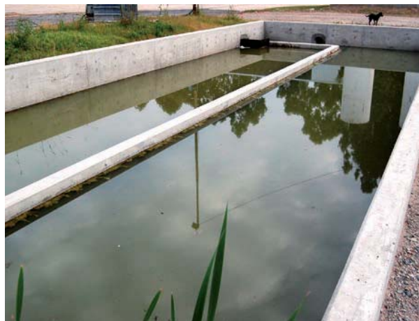
▲ F.10 Piletas de decantación.
