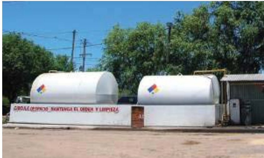
▲ F.18 Muro antiderrame
