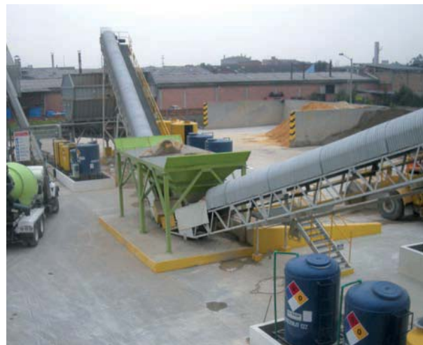
➤ F. 5 bis: Cintas transportadoras con cobertura metálica
