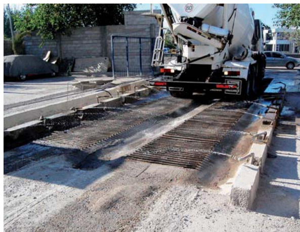
Fig. 1: Rejilla de contención para el lavado de neumáticos
