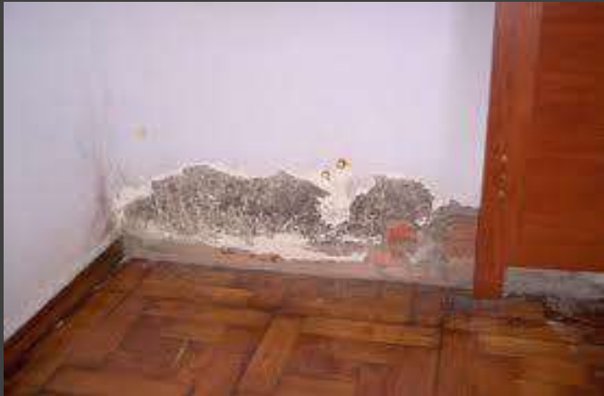
HUMEDAD DEL TERRENO
