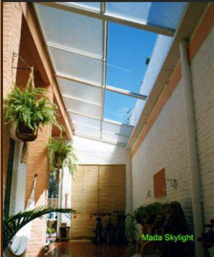
ILUMINACION POR TECHO (CENITAL)
