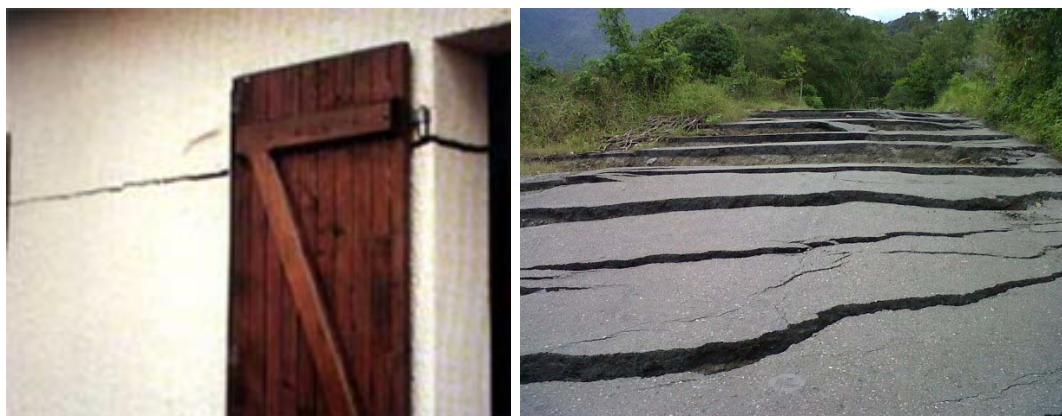
Figura 4.13: Daños en edificios (izquierda) [14] y pavimentos (derecha) por arcillas expansivas.
