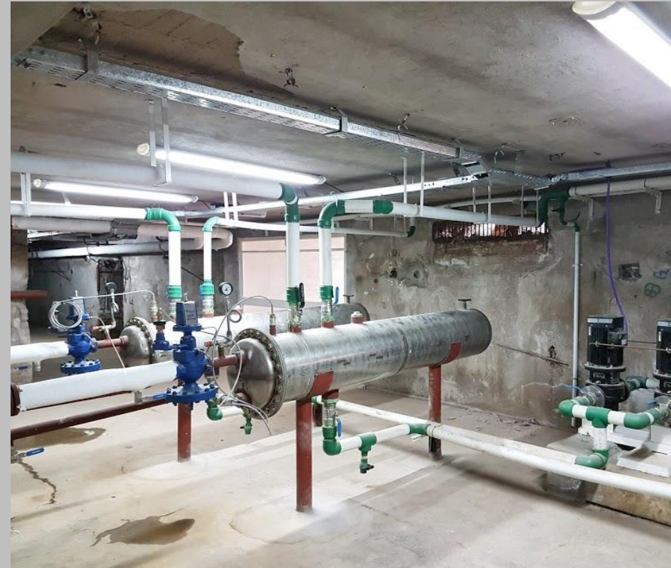
INTERCAMBIADOR DE CALOR, BOMBAS Y CAÑERÍAS
