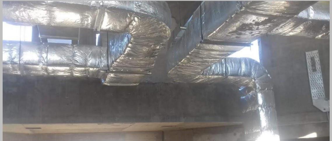
CONDUCTOS DE DISTRIBUCIÓN DE AIRE
