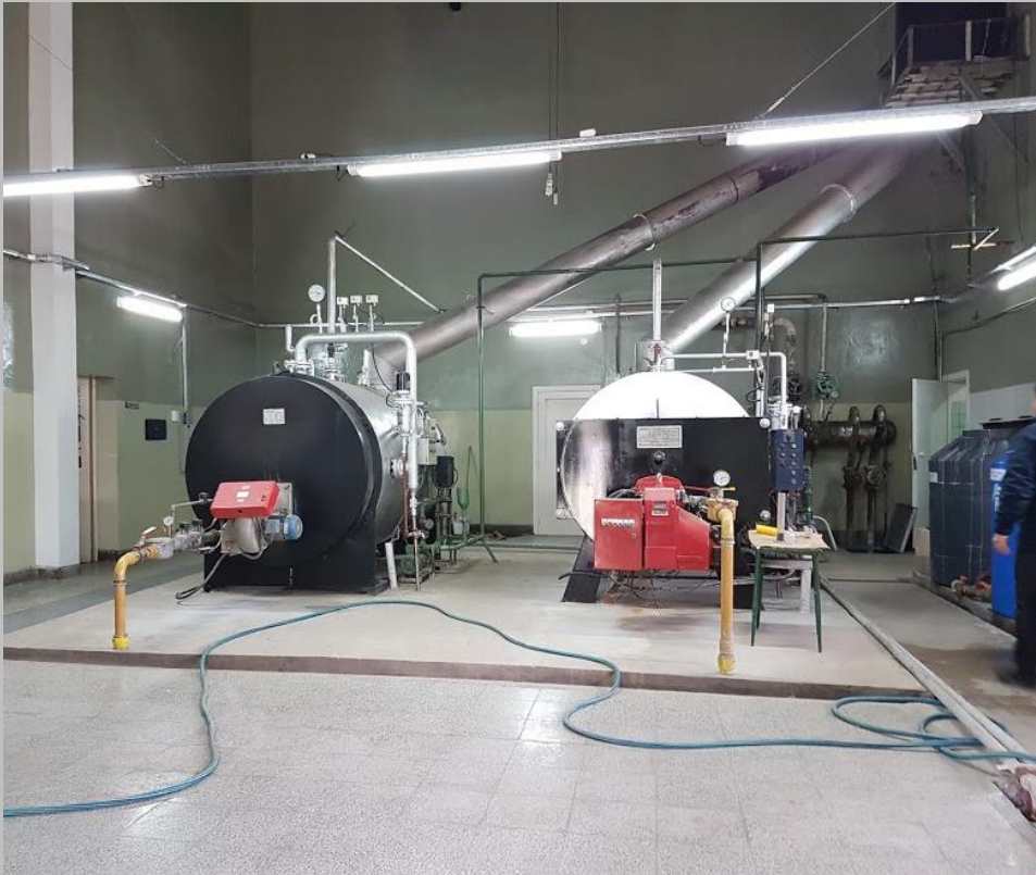
CALDERAS DE VAPOR
