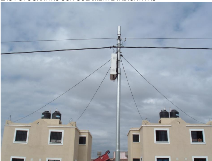
UBICACIÓN DE LAS CAJAS PERPENDICULARES A LA LÍNEA DE DISTRIBUCIÓN ACOMETIDAS DE VIVIENDAS TIPO DUPLEX. RETENCIÓN REALIZADA SOBRE LA PARED LAS FOTOGRAFÍAS SON SÓLAMENTE INDICATIVAS
