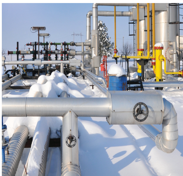
Planta de tratamiento de gas
