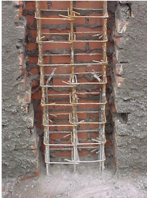
Foto 10. Dentado en la unión columna - muro.
