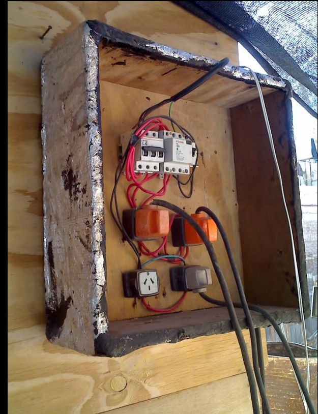
Caja de tablero interno de madera, llaves de corte, disyuntor y tomas
