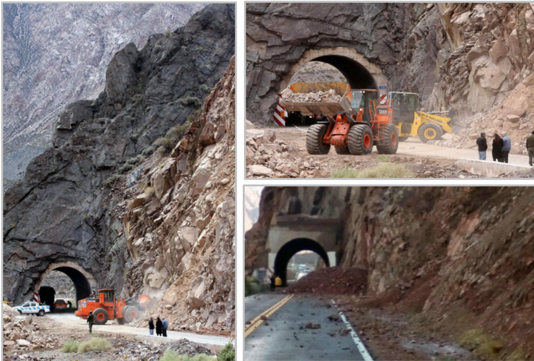
Fig 4. Caída de rocas sobre la boca oeste del túnel N°3 de la ruta internacional N°7 el 14/11/2011. El derrumbe causado por lluvias prolongadas impactó en un vehículo que transitaba matando una persona e hiriendo a otra.
