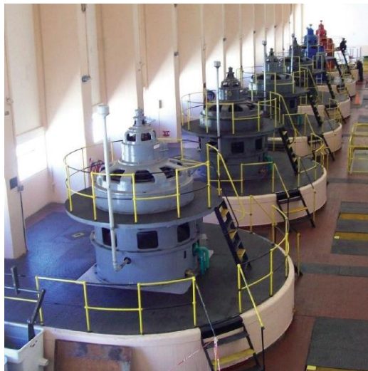
Vista de los seis generadores de la central Nihuil II
