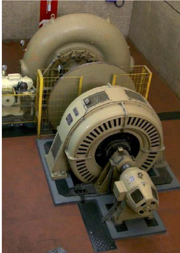
Vista de la turbina Francis de eje horizontal para arranque "en negro"
