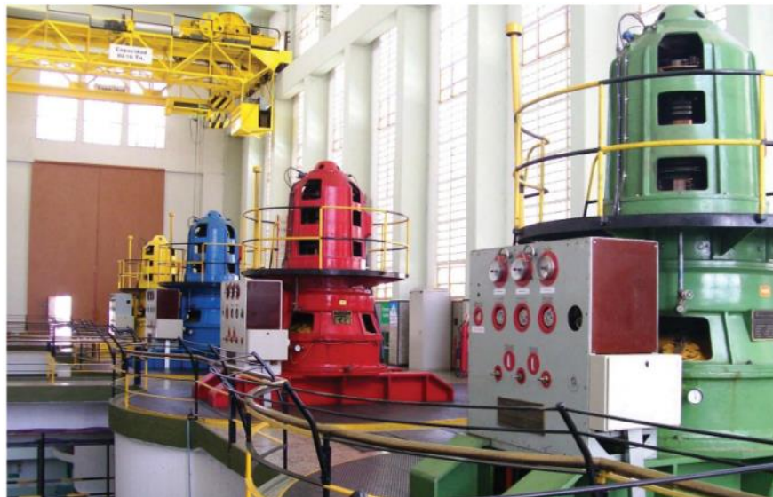
Vista de la central con los cuatro grupos generadores de la central Nihuil I
