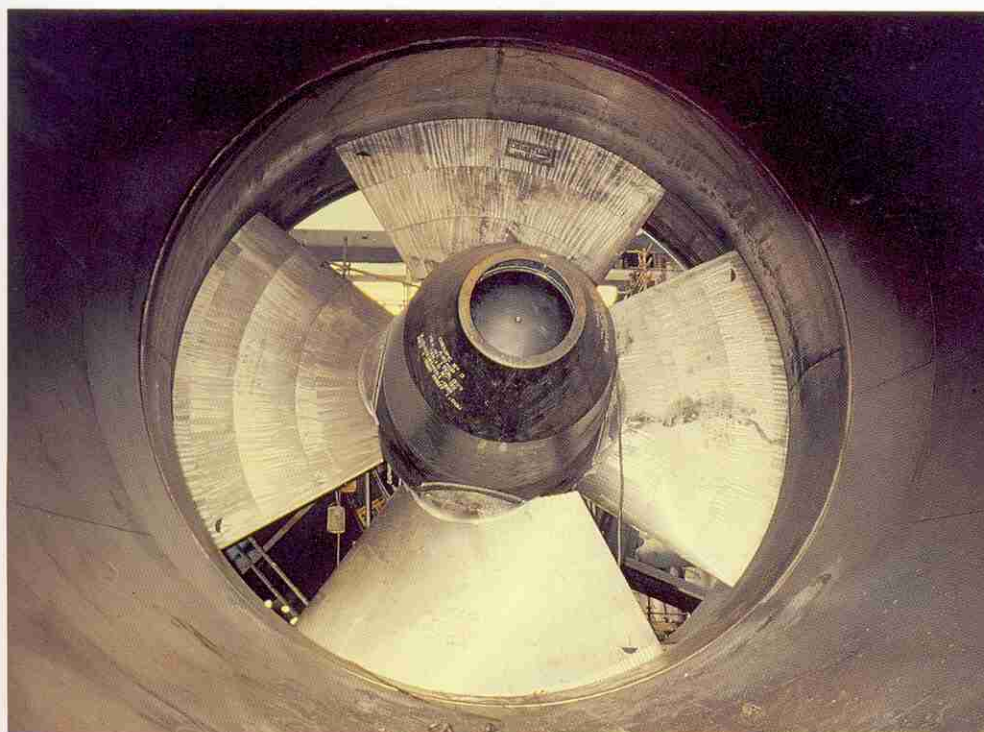
4. La roue vue depuis le diffuseur (photo Neyrpic)
