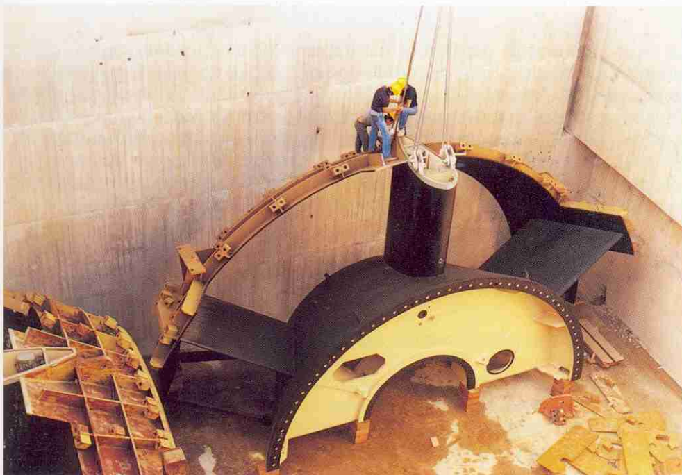
1. Avant-distributeur en deux parties comprenant 2 avant-directrices et un puits vertical (photo Neyrpic).
