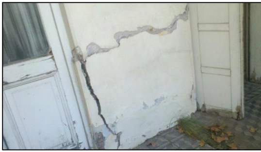
ii. Fisuras en esquina de marcos
