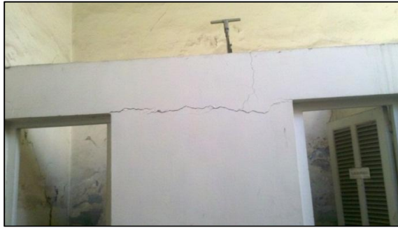
iii. Fisuras diagonales
