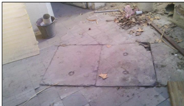
iv. Hundimiento del piso
