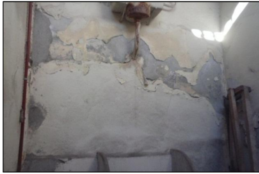
ii. Fisuras horizontales
