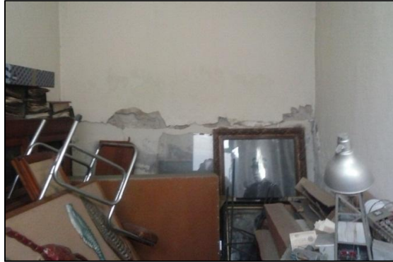
iii. Fisuras diagonales
