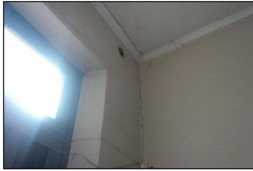
ii. Fisuras horizontales
