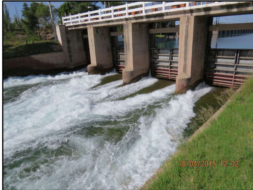
Figura 5.41. Resalto rechazado en las compuertas de riego del Dique Cipolletti, año 2015
