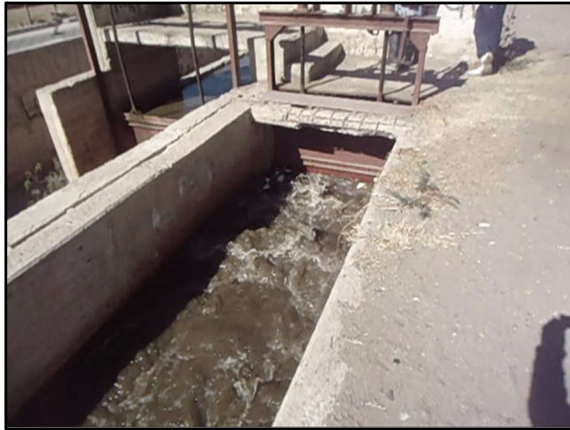
Figura 5.51. Resalto ahogado (nótese el color del agua debido al material en suspensión)
