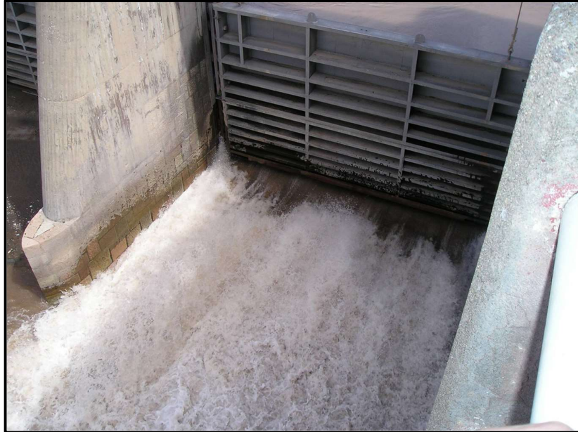
Figura 5.47. Resalto rechazado en compuerta del Dique Valle de Uco
