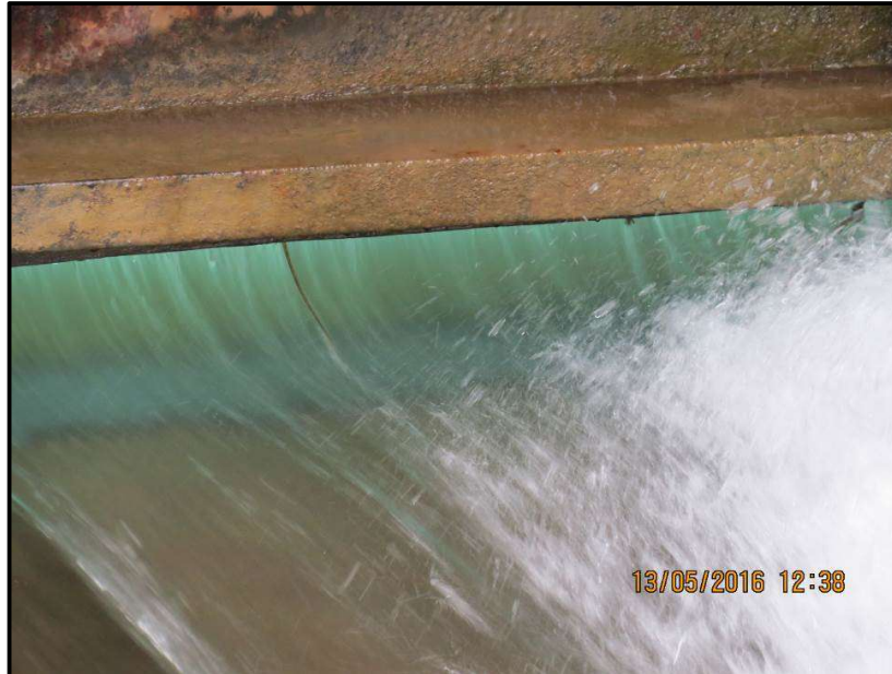
Figura 5.43. Vista de la sección contraída de salida del orificio bajo compuerta en el Dique Cipolletti (2016)
