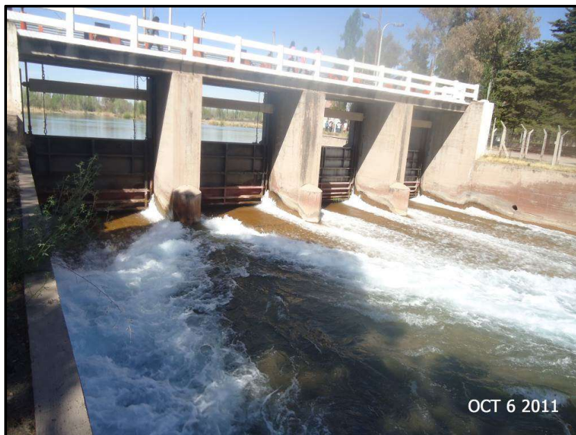
Figura 5.38. Vista desde aguas abajo de las compuertas de riego del Dique Cipolletti, resalto rechazado
