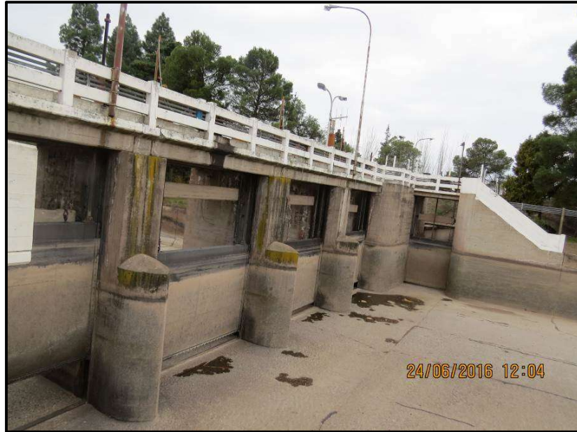
Figura 5.37. Vista desde la margen derecha aguas arriba de la compuerta de derivación del Canal Matriz margen derecha del Dique Cipolletti
