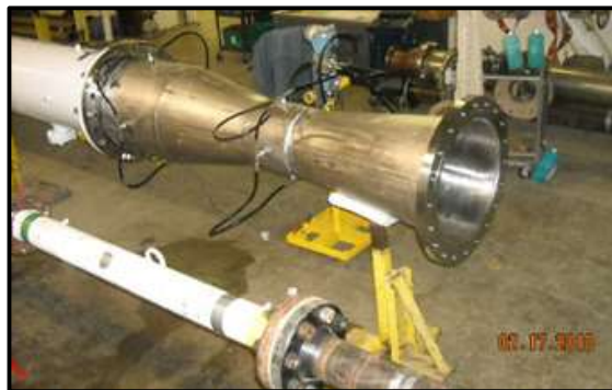
Figura 5.66. Instalación de un Tubo Venturi
