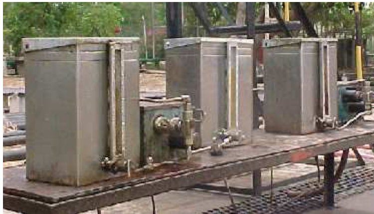
Foto N°1. Sistema de inyección de químicos
