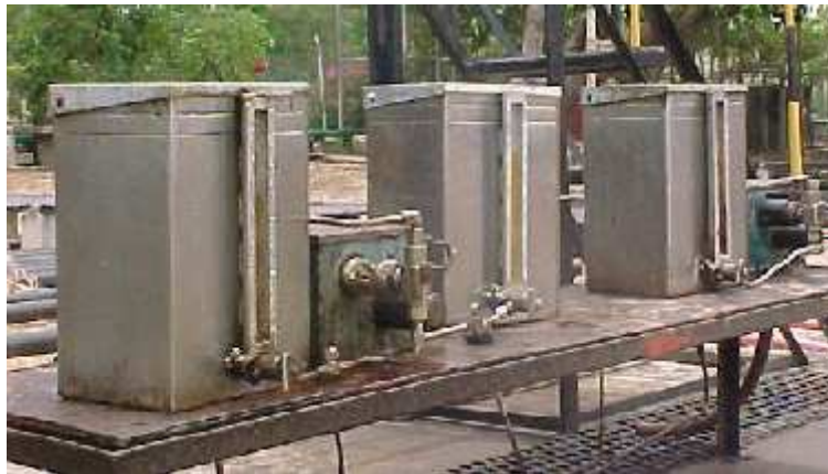
Foto N°4. Sistema de inyección de químicos
