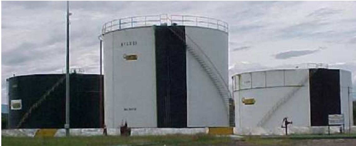
Foto N°9. Sistema de tanques de almacenamiento, en acero
