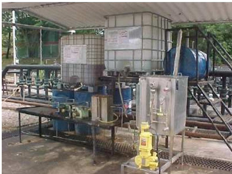
Foto N°2. Sistema de inyección de químicos
