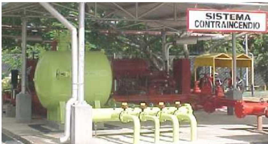
Foto N°12. Sistema contra incendio
