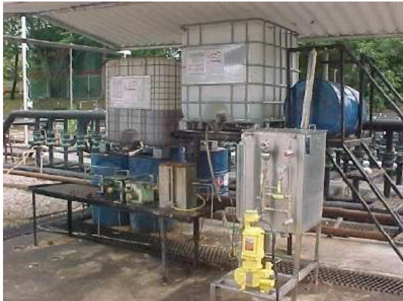
✓ Foto N°5. Sistema de inyección de químicos
