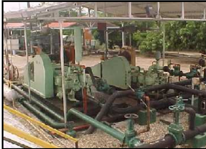
Foto N°10. Sistema de bombas de transferencia
