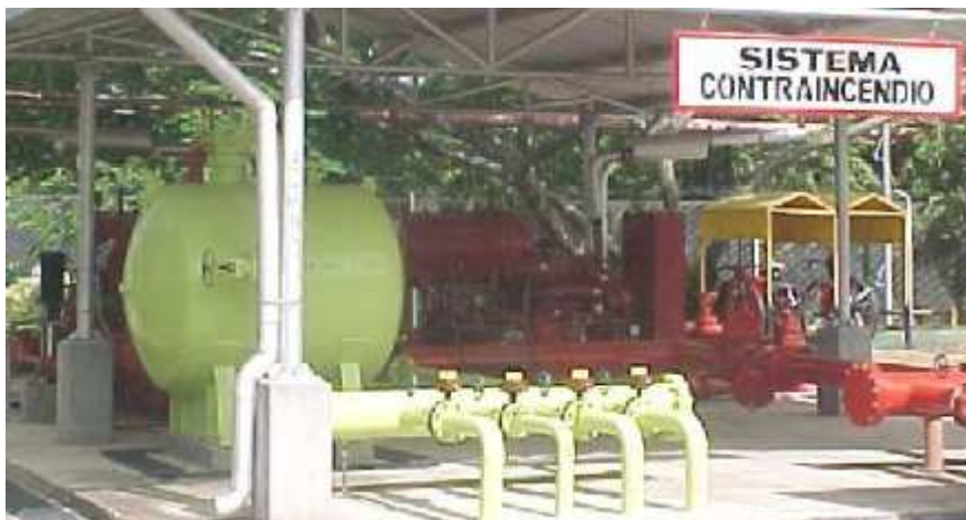
Foto N°12. Sistema contra incendio
