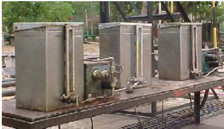
Foto N°4. Sistema de inyección de químicos
