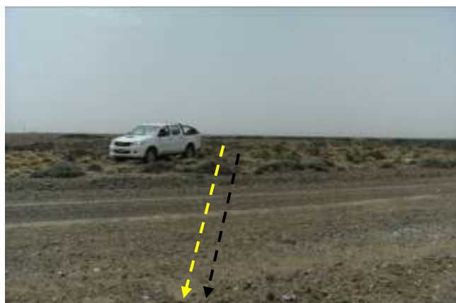
Foto III.B-22. Emplazamiento de ductos (oleoducto-negro- y gasoducto-amarillo). Foto en dirección E.
