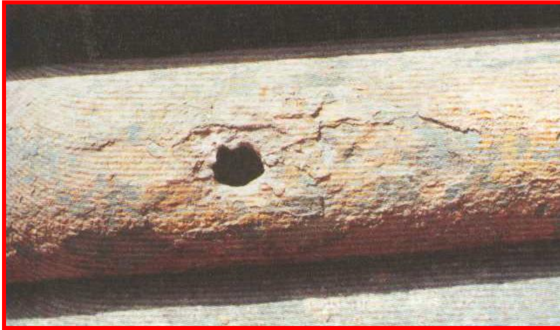
BIO-CORROSIÓN EN TUBO DE ACERO AL CARBONO
