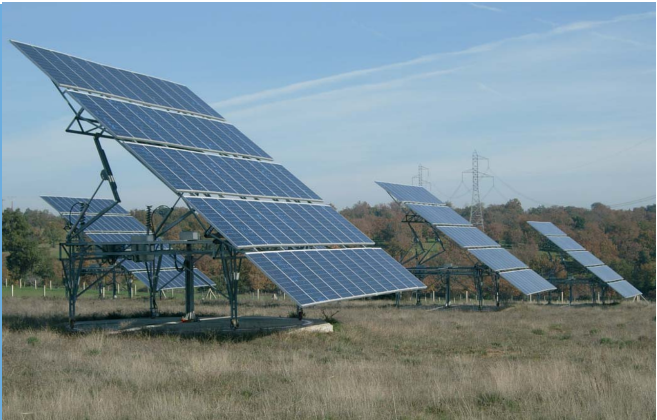
Figura 8.5. Paneles fotovoltaicos de silicio empleados en la producción de electricidad a partir de energía solar.
