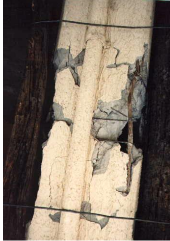
Figura 19: b)Foto ampliada del daño en la columna
