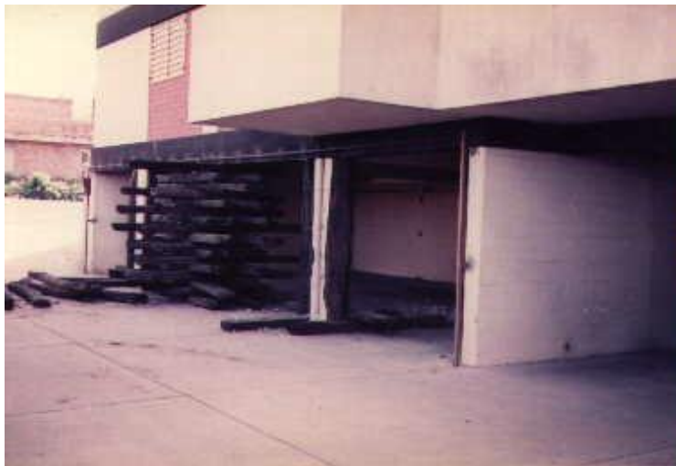
Figura 19: a) Daño en edificio de baja altura en el terremoto de Mendoza de 1985
