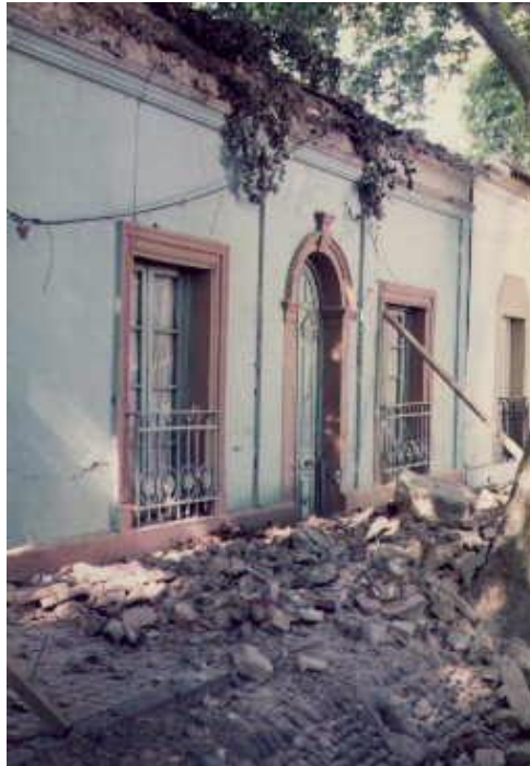
Figura 16: b) Colapso de parapetos y marquesinas en el terremoto de Mendoza de 1985
