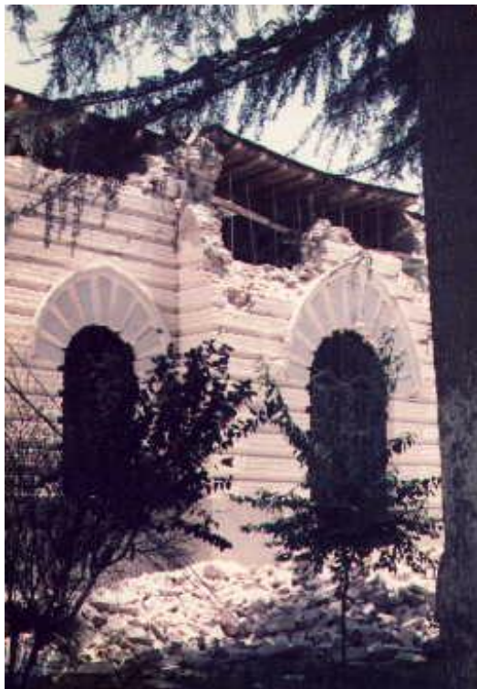
Figura 18: Colapso parcial en el hospital El Carmen en el terremoto de Mendoza de 1985
