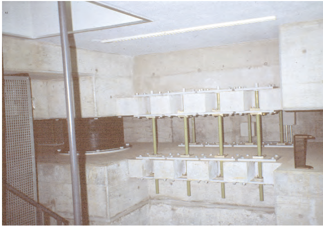
a) Amortisseurs hystériques (barreaux en acier doux) à proximité d'un isolateur. Les déplacements horizontaux autorisés par les isolateurs entraînent une flexion cyclique des barreaux dans le domaine plastique, ce qui dissipe de l'énergie en chaleur. Ce procédé est utilisé en France et au Japon
