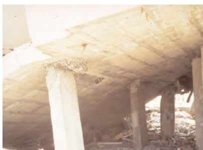
Fig. 2.29 c) Rupture typique des poteaux au droit des planchers (séisme de Ceyhan-Misis, Turquie, 27.6.1998)
