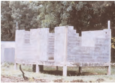
a) Solution incorrecte : des dommages dus à l'effet de poteau court sont à craindre
