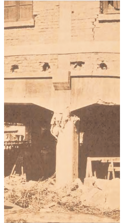
b) Rupture typique au droit d'un changement de rigidité. Le gousset, dont la présence est favorable, n'a pas suffi à prévenir la rupture du poteau lors d'un séisme de forte magnitude, mais il a vraisemblablement prévenu l'effondrement de l'immeuble (séisme de Tangshan, Chine, 27.6.1976, magnitude 7,9)
