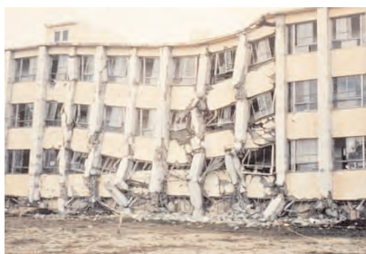
Fig. 2.72. - Rupture de poteaux d'une construction ne respectant pas le principe " poteau fort-poutre faible " (séisme de Tokachi-Oki, Japon, 16.5.1968).
