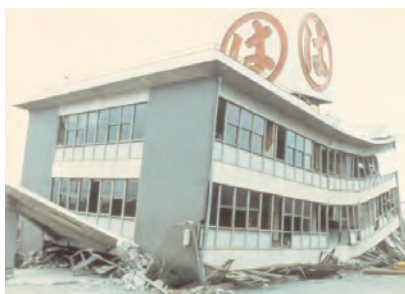
a) Rez-de-chaussée écrasé après la rupture des poteaux (séisme de Tokachi-Oki, Japon, 16.5.1968)
