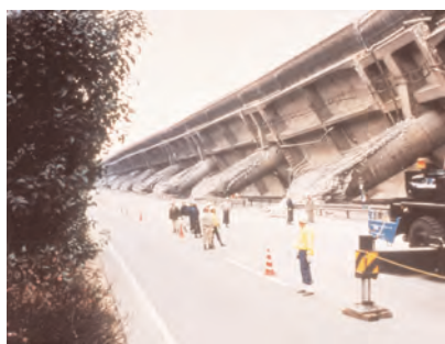
Fig. 2.85. - Basculement de l'autoroute urbaine de Kobé lors du séisme du 17.1.1995. Une seule rupture par poteau suffit pour entraîner l'instabilité de l'ouvrage. Le basculement aurait pu être prévenu en faisant porter le tablier par des voiles transversaux ou par des portiques.
