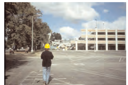
Fig. 1.1. - Bâtiment à usage de parking, réalisé selon les règles parasismiques américaines. Effondrement dû à une conception peu judicieuse : la rampe d'accès aux étages limitait la déformabilité des poteaux qui la supportaient. Faire porter la rampe par un voile de béton armé aurait constitué une solution plus adéquate (séisme de Northridge, Californie, 1994).
