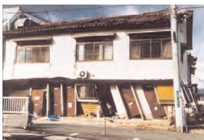
Fig. 2.30. - Dommages au rez-de-chaussée affaibli par de grandes ouvertures (séisme de Kobé, Japon, 17.1.1995).
