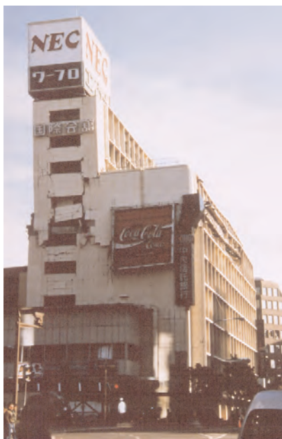
b) Bâtiment endommagé par le séisme de Kobé, Japon (17.1.1995). La partie supérieure du bâtiment n'oscille pas à la même fréquence que sa partie inférieure
