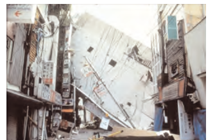
Fig. 1.2. - Basculement d'un bâtiment calculé au séisme suite à l'effondrement du rez-de-chaussée commercial dont la rigidité horizontale était très inférieure à celle des étages (séisme de Kobé, 1995).
