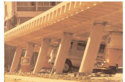
b) Rupture des poteaux sous l'effet de la charge horizontale. Aucun contreventement longitudinal n'apparaît sur la figure. Transversalement, la résistance des portiques a été insuffisante pour assurer la stabilité (séisme de San Fernando, Californie, 9.2.1971)
