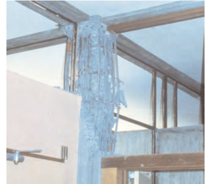
Fig. 2.56. - Dommages dus à l'effet de poteau court (séisme de Tokachi-Oki , Japon, 16.5.1968).
