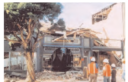
b) Eclatement d'un panneau de remplissage en maçonnerie et chute sur un immeuble voisin (séisme de Loma Prieta, Californie, 17.10.1989)
