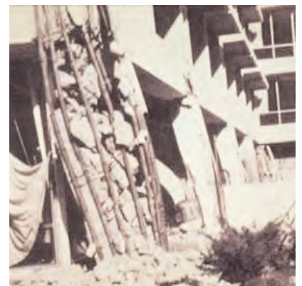
a) Le poteau d'angle est beaucoup plus endommagé que les autres poteaux (séisme de San Fernando, Californie, 9.2.1971)
