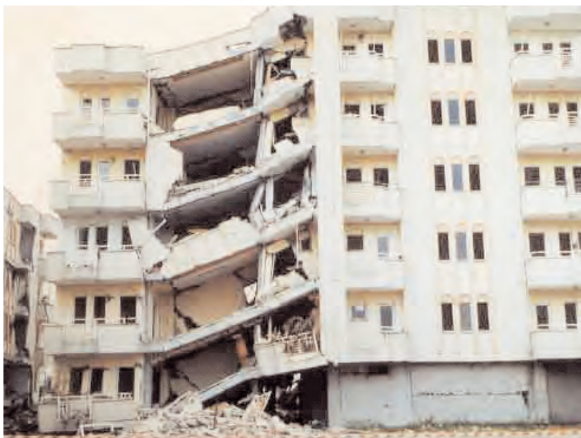
b) Effondrement partiel du rez-de-chaussée d'un immeuble d'habitation. L'effondrement total a été empêché par la présence du mur en blocs de béton (séisme de Ceyhan-Misis, Turquie, 27.6.1998)
