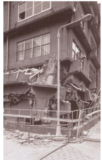
Fig. 2.25. - Dommages aux éléments de façade en saillie ou retrait (séisme de Kobé, Japon, 17.1.1995).
