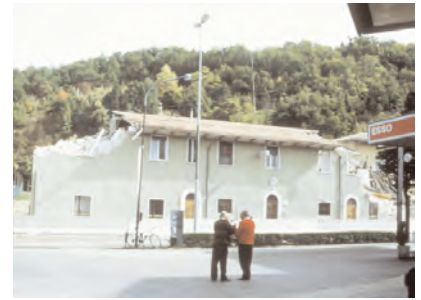
Fig. 2.18. - Bâtiment long ayant subi des dommages importants à ses extrémités (séisme de Colfiorito, Italie, 26.09.1997).
