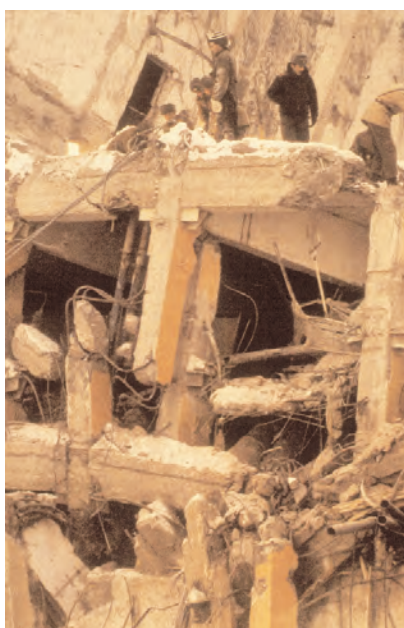
Fig. 2.73. - Rupture fragile des poteaux et des poutres entraînant l'effondrement de l'ouvrage (séisme de Spitak, Arménie, 7.12.1988).
