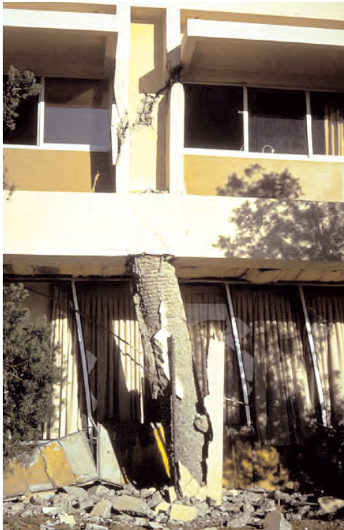
a) Rupture atypique d'un poteau. Le confinement dense du béton à ses extrémités a prévenu l'éclatement dans ces zones (séisme de San Fernando, Californie, 9.2.1971, magnitude 6,6)
