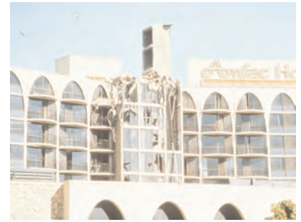
Fig. 2.63. - Chute d'un réservoir d'eau implanté sur le toit d'un immeuble " parasismique " (séisme de Loma Prieta, Californie, 17.10.1989).
