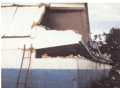
b) Effondrement de poutres en console (séisme de Cariaco, Vénézuéla, 9.7.1997)
