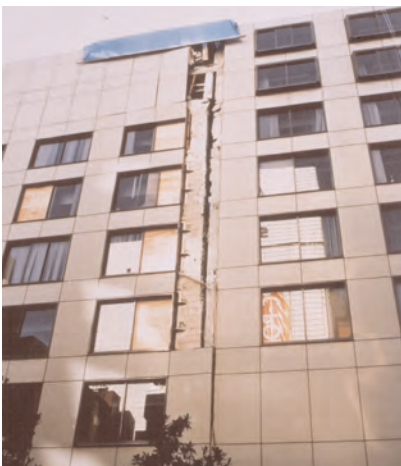
c) Dommages au revêtement en pierre constituant un couvre-joint rigide fixé de part et d'autre du joint (séisme de Kobé, Japon, 17.1.1995)
