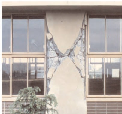
a) Poteau bridé de deux côtés : deux fissures diagonales se sont produites sous l'effet d'une sollicitation en cisaillement
