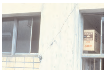
b) Poteau bridé d'un côté : une seule fissure diagonale a été provoquée, correspondant à la déformation du poteau vers l'allège. Dans le sens de la porte vitrée, le poteau a été sollicité en flexion et a toléré sans dommages la déformation imposée par le séisme
