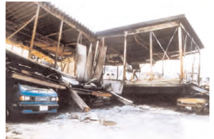
a) Bâtiment dont le rez-de-chaussée s'est effondré en raison de l'absence de contreventement. La stabilité de l'étage, contreventé par des tirants croisés, a été assurée (séisme de Kobé, Japon, 17.1.1995)
