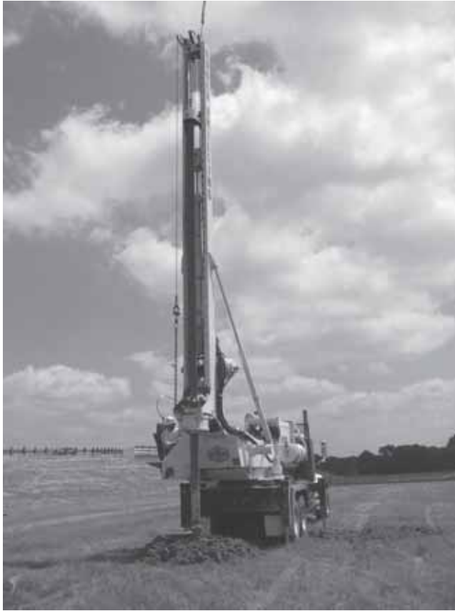
Figura 19.3 Perforación para la construcción de un pozo en el campo (Cortesía de Anand J. Puppala, Universidad de Texas en Arlington, Arlington, Texas)
