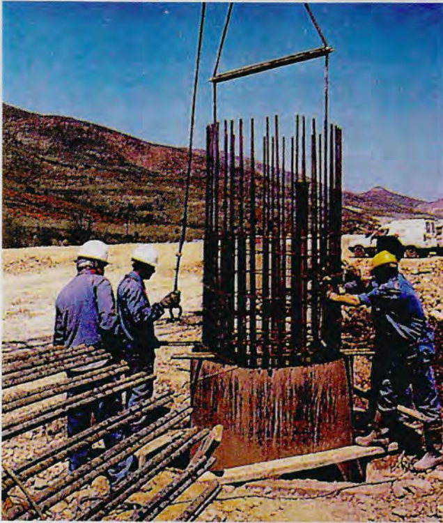
Figura 8.23 Colocación de armaduras en pilotes hormigonados in situ (cortesía de Grupo Terratest).
