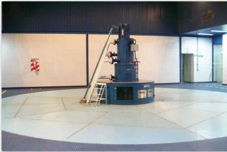
Vista del generador de la central
