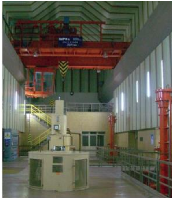
Vista de la central y de uno de los grupos generadores.
