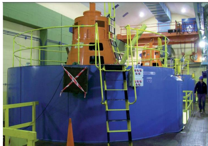
Vista de la central con ambos grupos generadores
