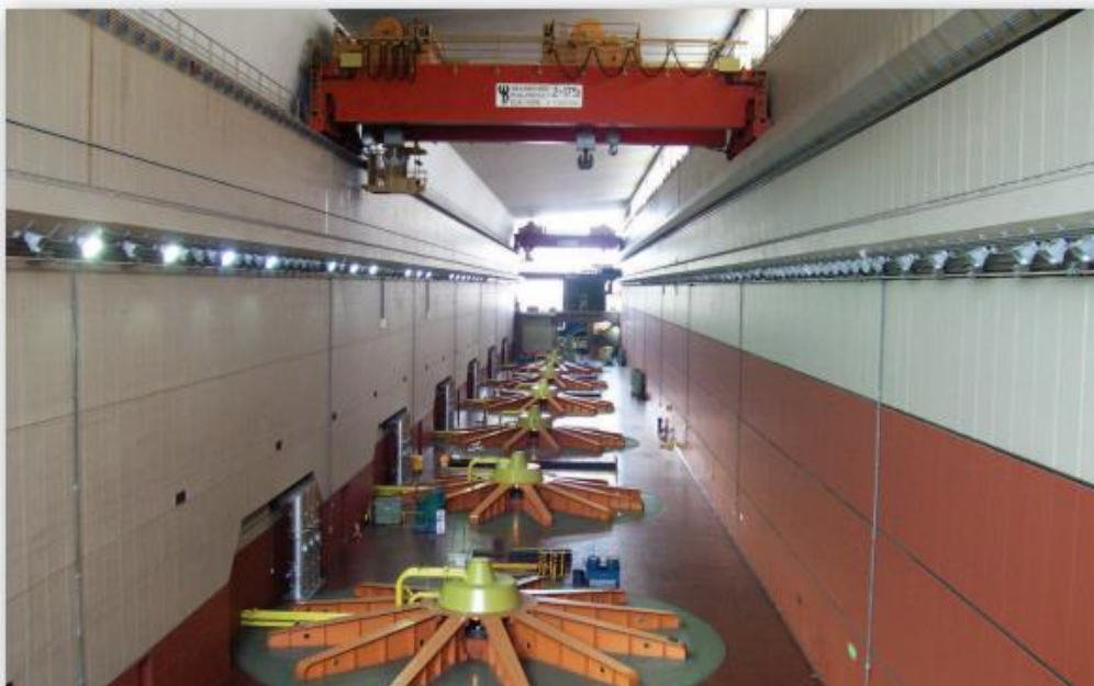
Vista de la central de margen derecha (idéntica a la de margen izquierda), con sus siete grupos generadores.
