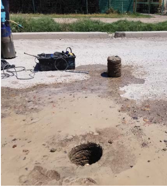
^ Pavimento nuevo con calidad inferior a H-13 donde no se hicieron probetas y tuvieron que demolerse varias cuadras.
