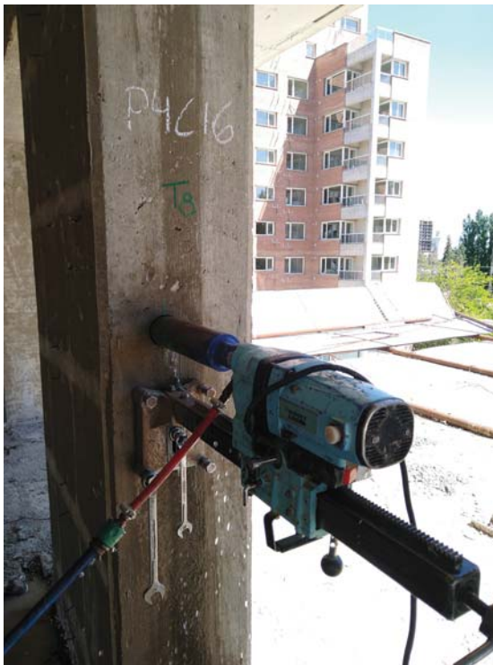
^ Testigos extraídos en un edificio de altura con controles de calidad inexistentes en la construcción.
