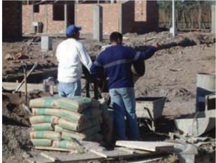
▲ Bolsas de cemento que no siempre llegan al hormigón
