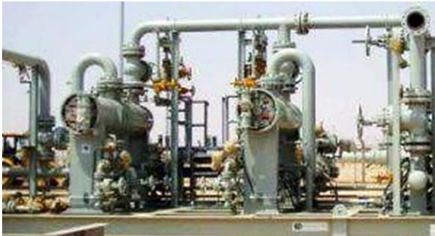
Fig. 16: estación de bombeo en gasoducto
