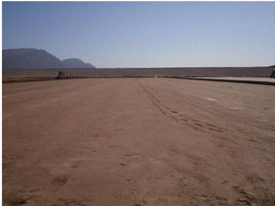
Figura I.8 Vista de la construcción de la base de impermeabilización del fondo del actual Relleno Sanitario
