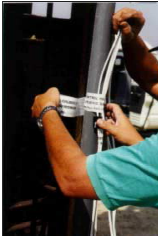
FOTO V-9 - Instalación de las líneas de termistancias
