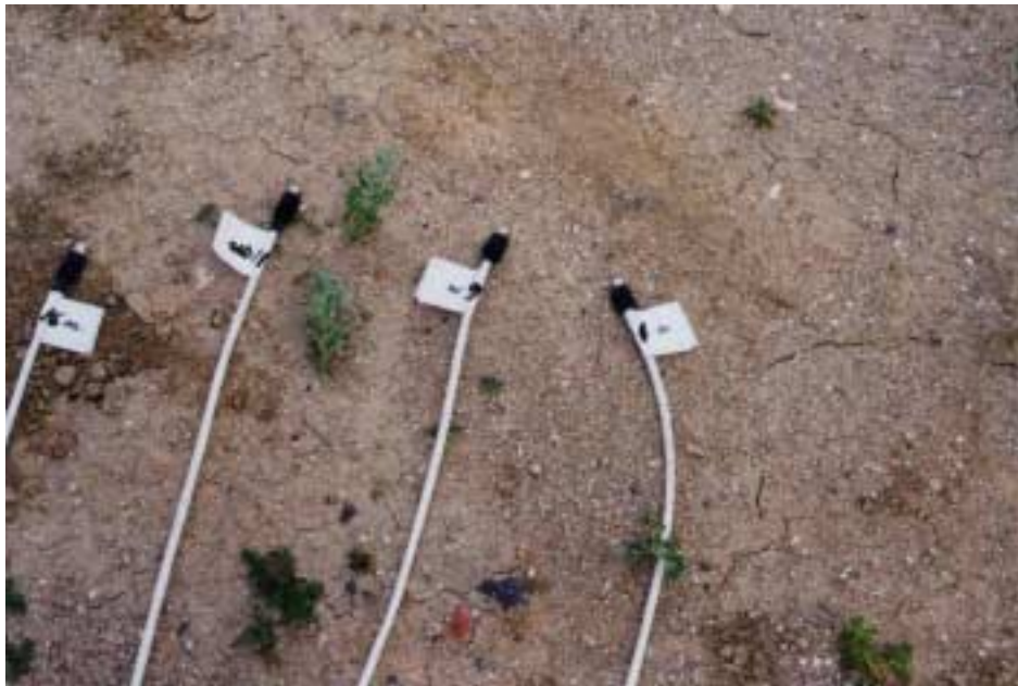
FOTO V.10 - Cables de la línea de termistancia
