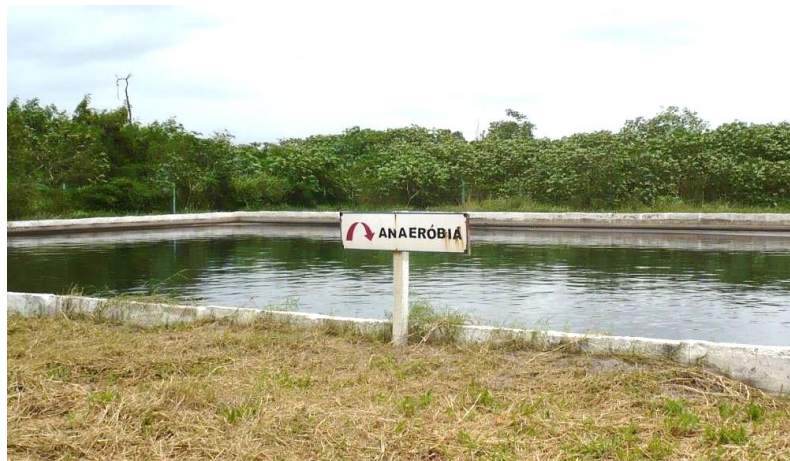
FIGURA 14. Tratamiento de lixiviados
