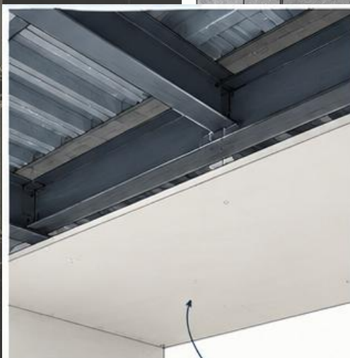
Cielorraso de placa de yeso
