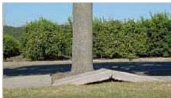
Imag. 4.13 Banquetas deterioradas por raíces de árboles
