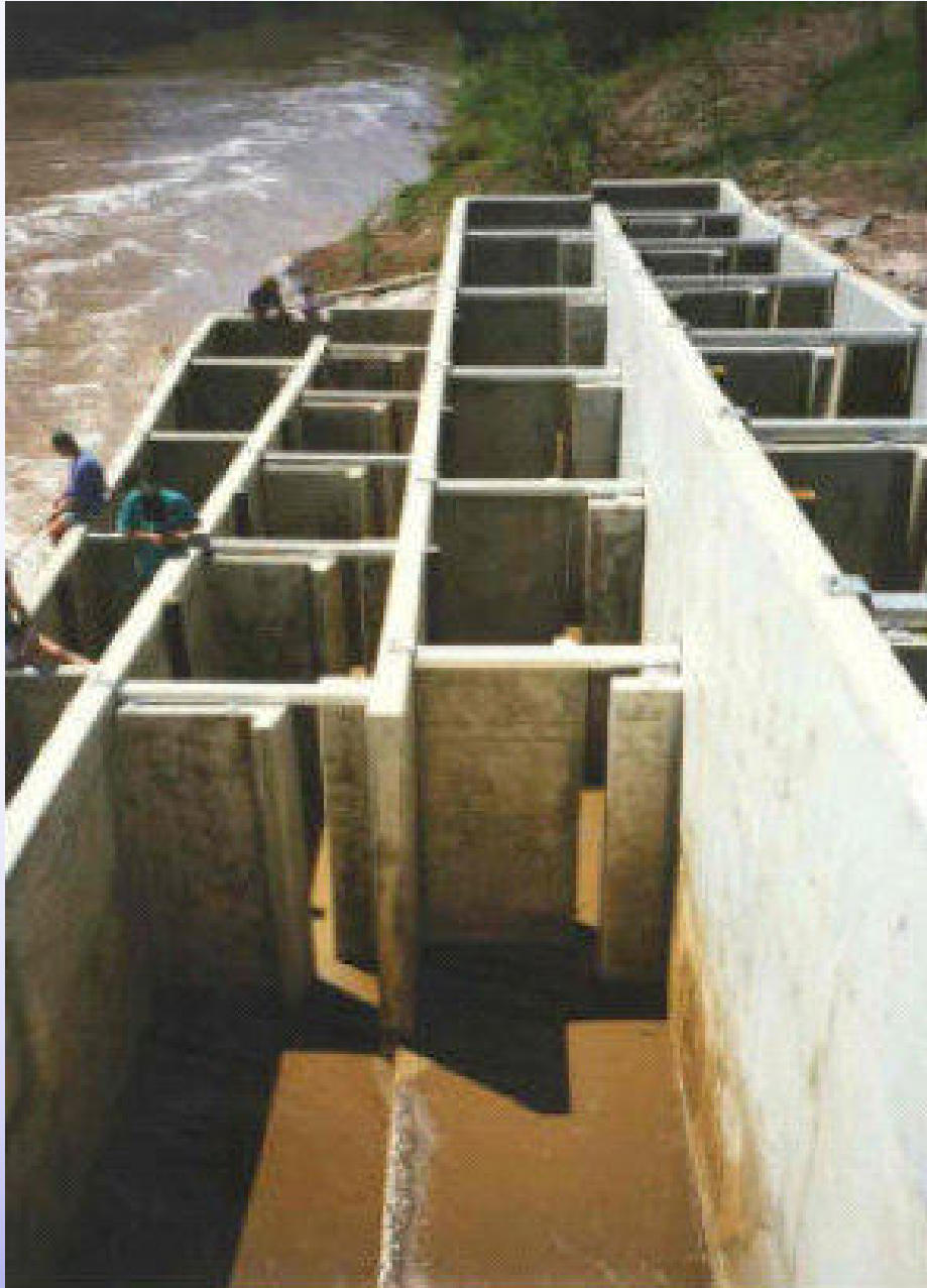
Foto 3. Escala de artesas comunicadas por hendiduras verticales.
