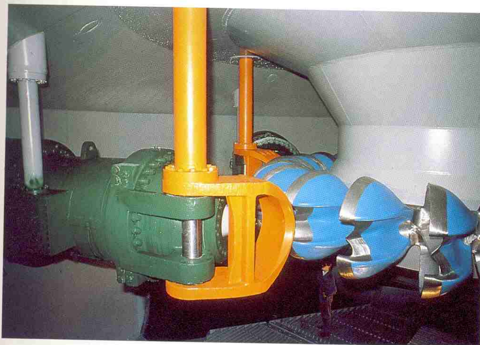
4. Injecteur, déflecteur et roue. Le tube gris contient les tuyaux d'huile sous pression pour la commande du pointeau (photo Kvaerner Hydro).
