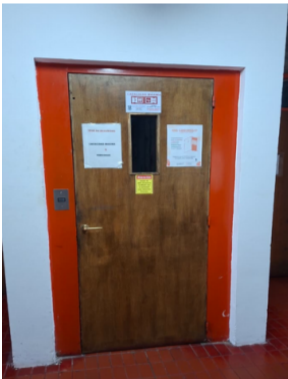
Figura 11. Circulación vertical: ascensor
