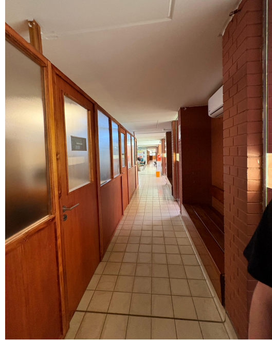
Figura 23: Iluminación sobre pasillo este.
